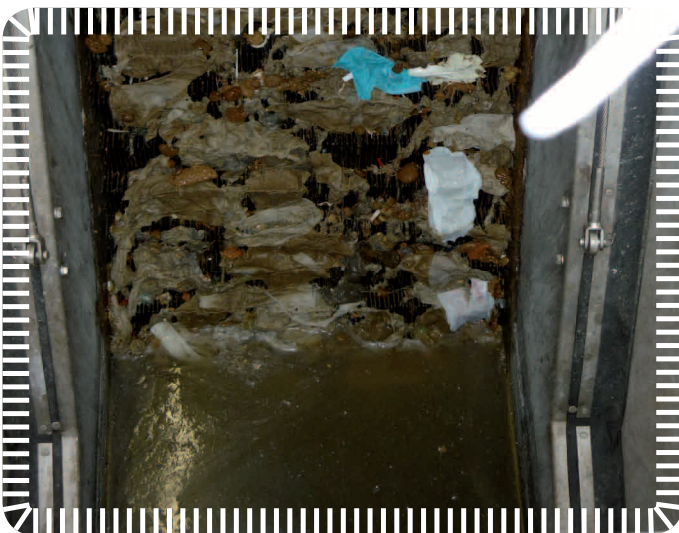
Abfall im Rechen
