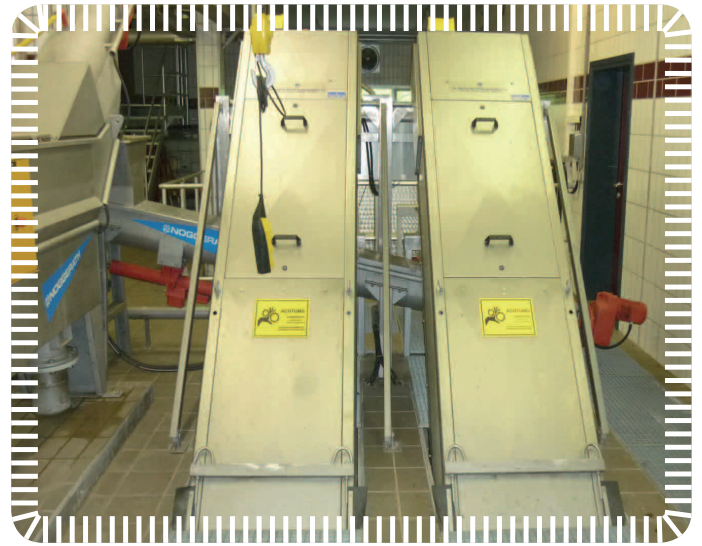
Rechenanlage im Klärwerk in Wemms (Fotos: Abwasserverband Pitztal)
