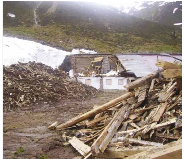
Die zerstörte Neubergalm-Hütte (Fotos: privat).
