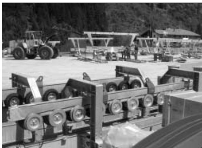
Die Vormontage der Stütze - insgesamt 900 Tonnen Stahl, die bis zu einem Gewicht von 3,5 Tonnen mit dem Hubschrauber transportiert werden konnten (6er-Sesselbahn Gletschersee).
